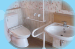
居室内 トイレ・洗面台
